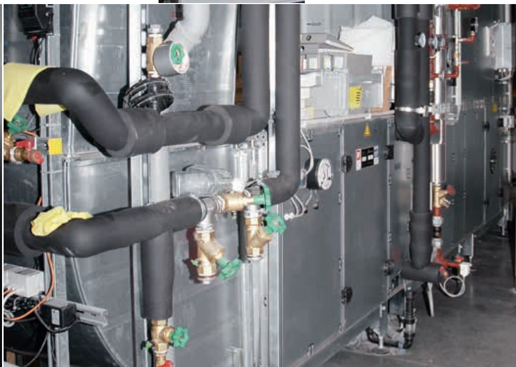
Die RLT-Anlagen im Techniraum sorgen für angenehme Temperaturen in den Büroräumlichkeiten.
