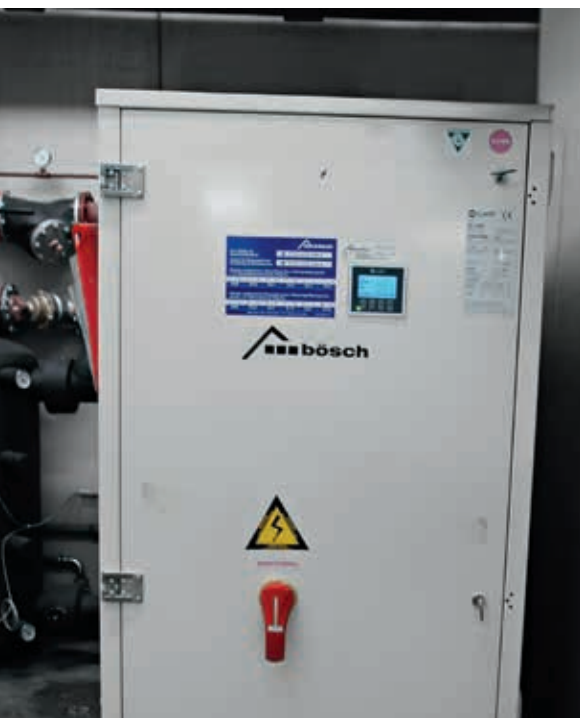
Die Kältemaschine von bösch ist kompakt untergebracht.
